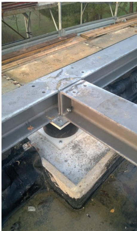
L'impalcato metallico poggiato sull'isolatore sismico.
